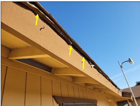
Missing drip edge
